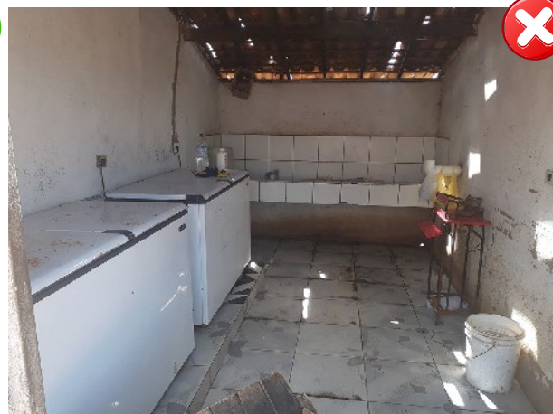
Figura 46 - Queijaria com pisos e paredes inadequadas e sujas
